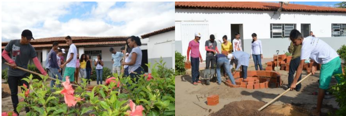
Figura 4. Intervenção no jardim do pátio escolar, com a construção de uma espiral de ervas pelos alunos da EFA Sobradinho e equipe de extensão da UNIVASF.
